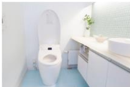
トイレや水回り
